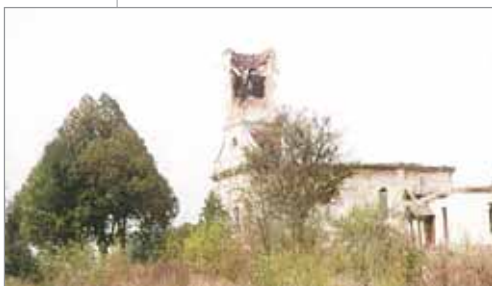
Župna crkva sv. Antuna Padovanskog u Bučici Gornjoj iz 1836. godine, koja je teško oštećena, te zapaljena u rujnu 1991. g.
